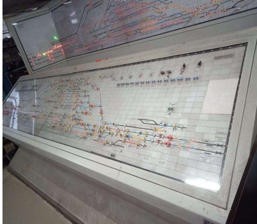
गोरखपुर स्टेशन पर रूट रिले इंटरलॉकिंग पैनल
