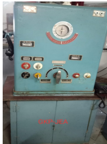
सिंगल लाईन टोकनलेस ब्लॉक उपकरण
