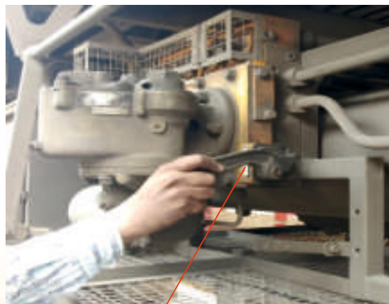
डी वी का आइसोलेटिंग हैंडिल आइसोलेट अवस्था में
