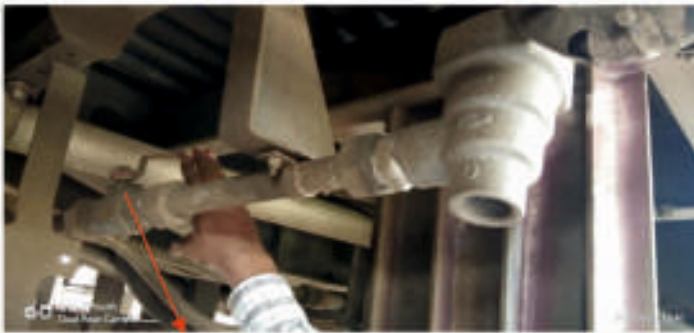
आइसोलेटिंग कॉक, आइसोलेटेड अवस्था में
